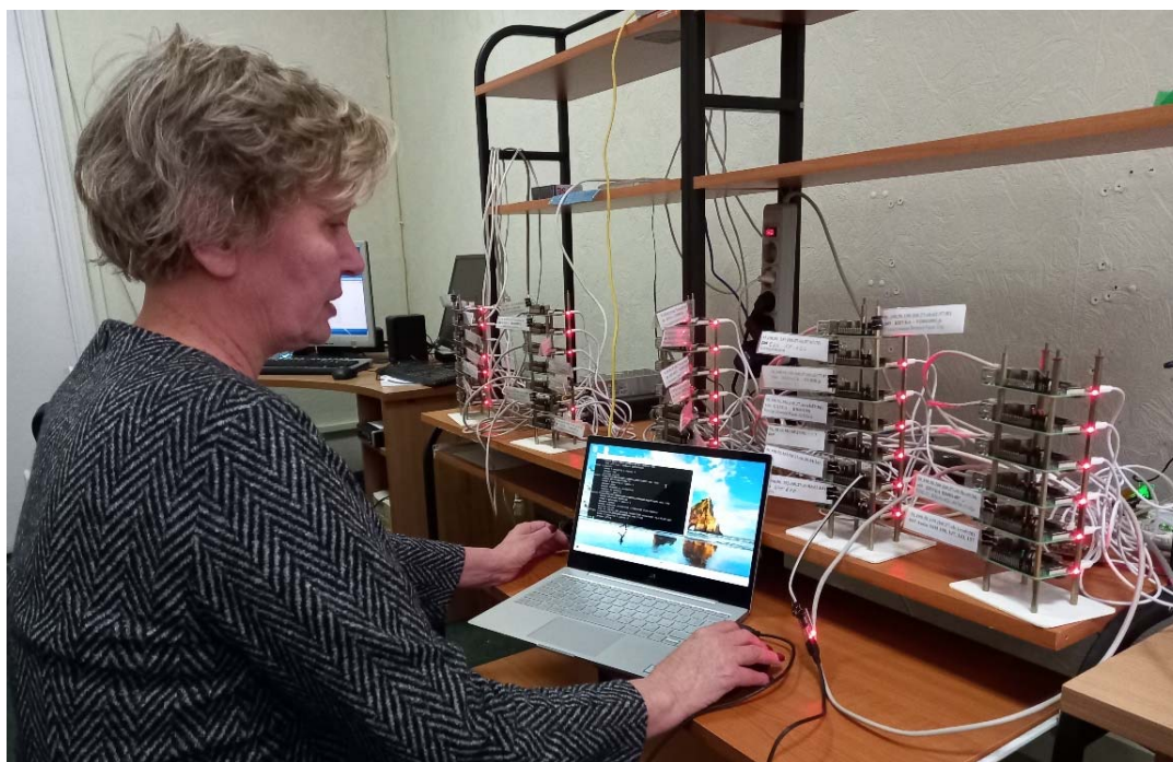
Рис. 13. Робота аудитора через консоль з відкритим блоком серверів.
